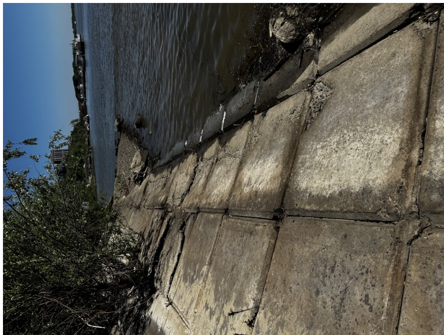
Рисунок 2 - Разрушение бетонных плит крепления у Речного вокзала: трещины, сколы, расширение швов, просадка плит, оголение арматуры DOI: https://doi.org/10.60797/IRJ.2026.170.4.4
