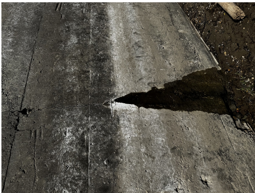
Рисунок 1 - Дефекты бетонной подпорной стенки Михайловской набережной: вертикальные трещины, сколы, обнажение арматуры, белые и зелёные пятна (выщелачивание и биопоражения), следы влаги и растительность у основания
