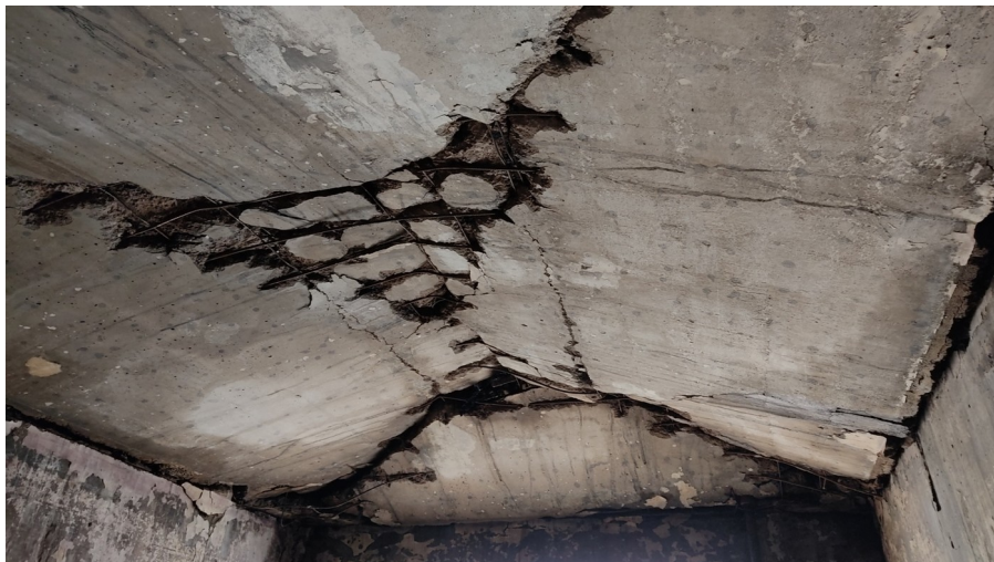
Рисунок 14 - Плита перекрытия в подвале 6 после взрыва DOI: https://doi.org/10.60797/IRJ.2026.167.82.21
