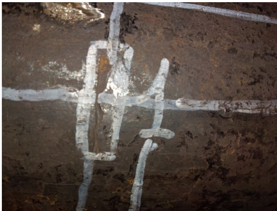
Рисунок 4 - Фотография дефекта тип: поперечная трещина DOI: https://doi.org/10.60797/IRJ.2024.143.178.4
