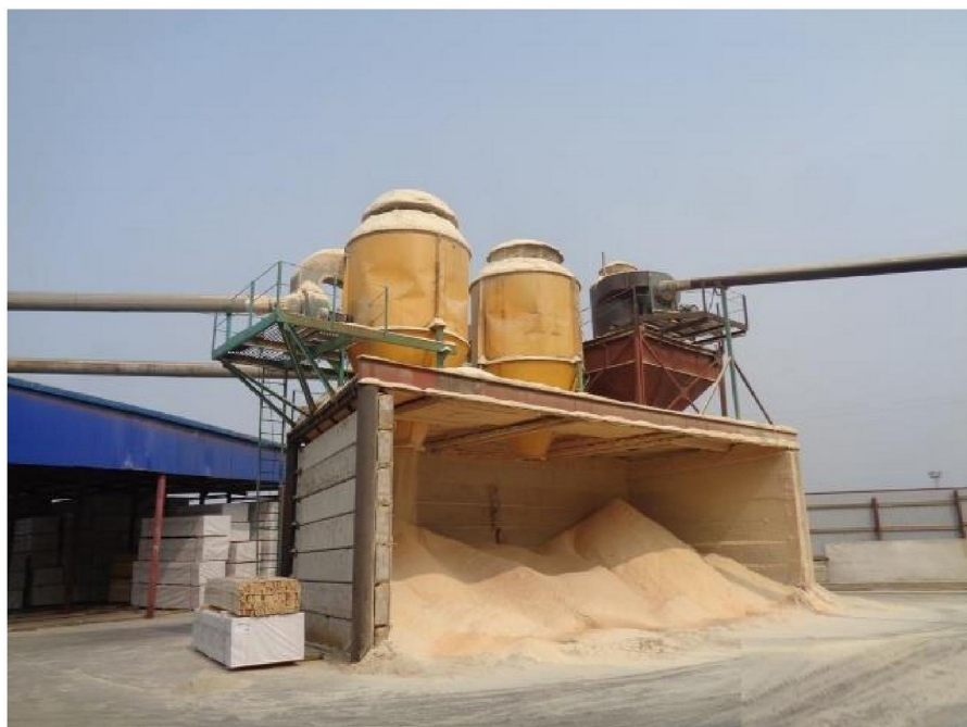
Рисунок 1 - Общий вид рассматриваемой наружной отделительной установки
